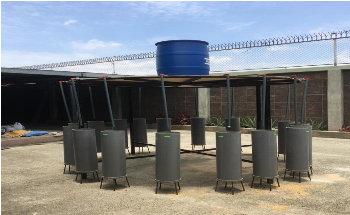
Anexo 3.1. Equipo de tratamiento para agua residual
