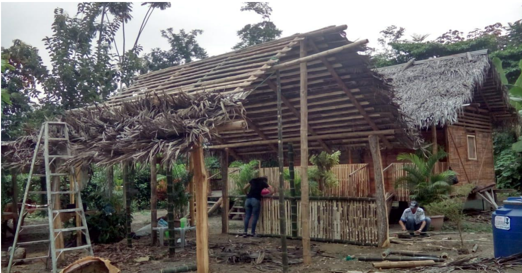
Esta cortando las latillas para el alrededor de la casa y la ubicación del cade para la cubierta del caballete
