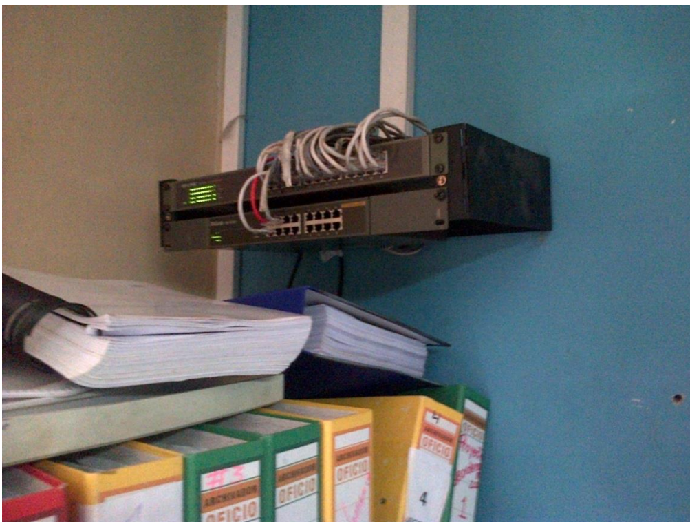
Anexo 5-B. Escasa seguridad de los equipos de red
