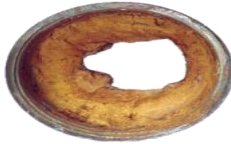
Ilustración 2.1. Ejemplo de incrustación en las tuberías.
