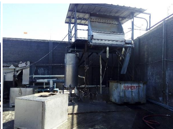
Criba y desarenador
