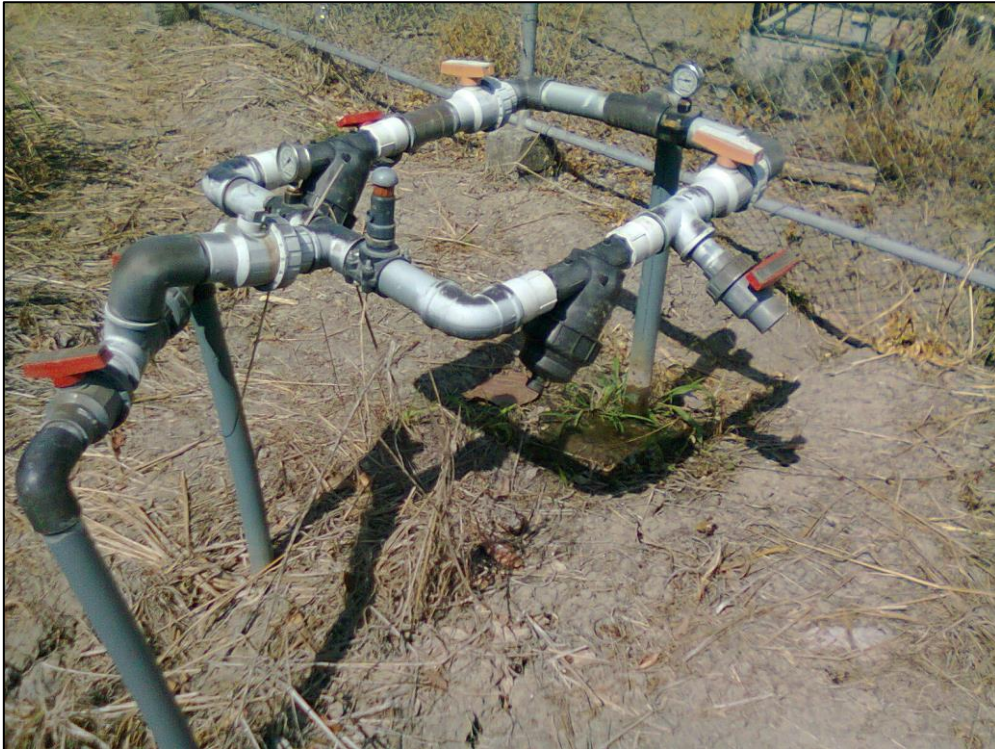
Figura 3. 2 Estación de válvulas del sistema de riego.
