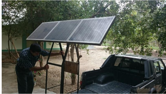
Anexo 2. B. Instalación de los paneles en la base de la estructura en la glorieta y cableado
