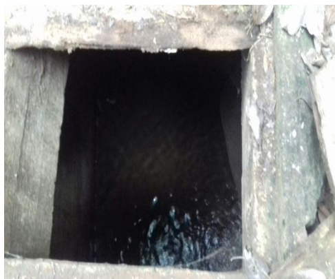
Foto 4.12. Reservorio de agua de la comunidad de Matapalo
