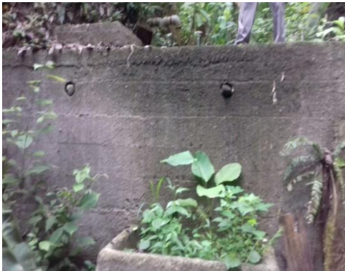
Foto 4.10. Reservorio de agua de la comunidad de Matapalo
