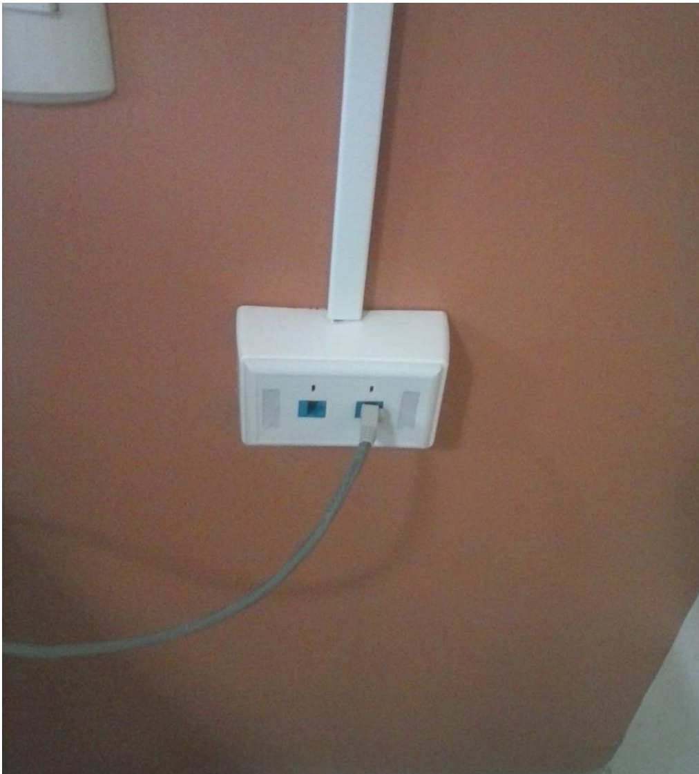
Foto 8 Finalización de instalación de cuatro puntos de conexión internet y telefonía IP
