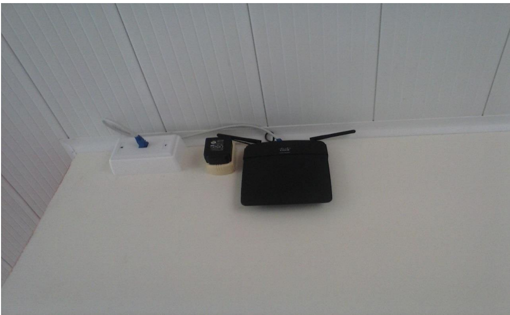
Foto 10 Access Point ya instalado y configurados.
