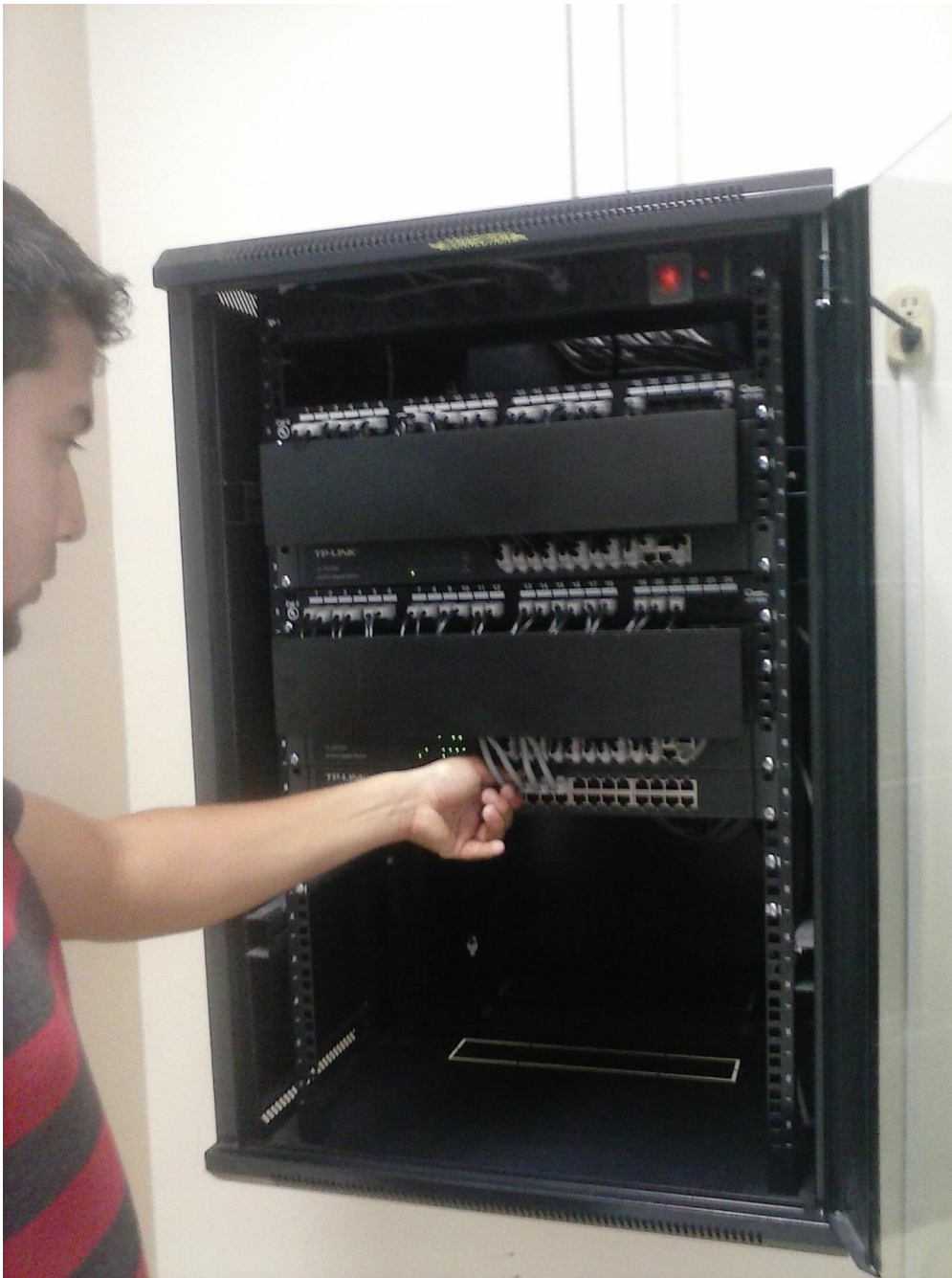
Foto 19 El autor finalizando las conexiones en el equipo principal
