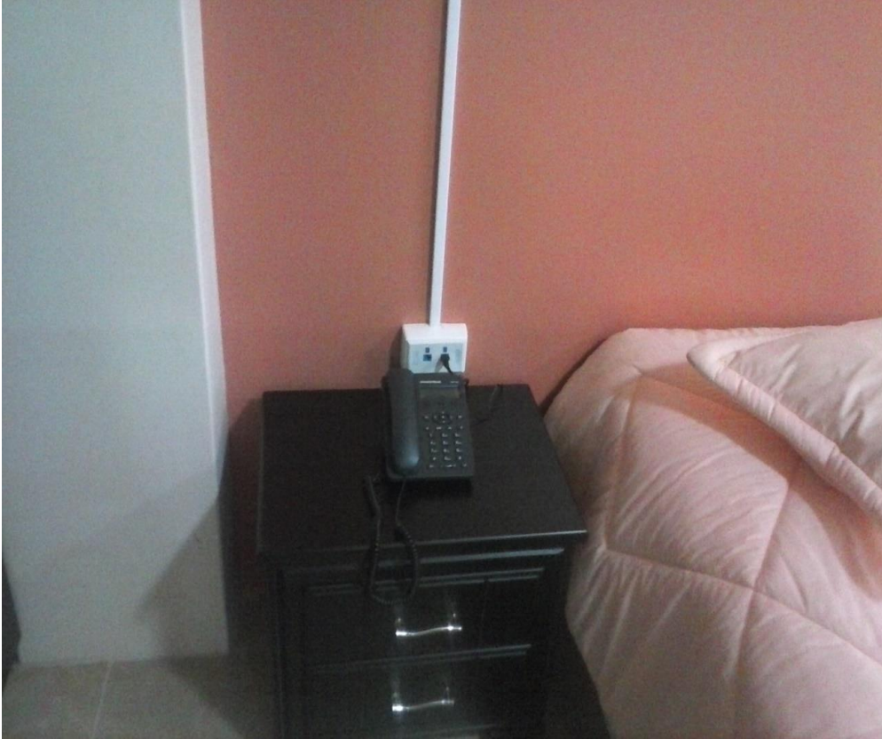
Foto 18 Teléfono ya instalado y configurado por el autor
