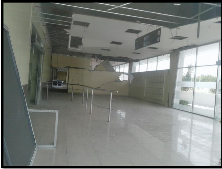
Recepción del Aeropuerto Internacional Eloy Alfaro de Manta, destruida.
