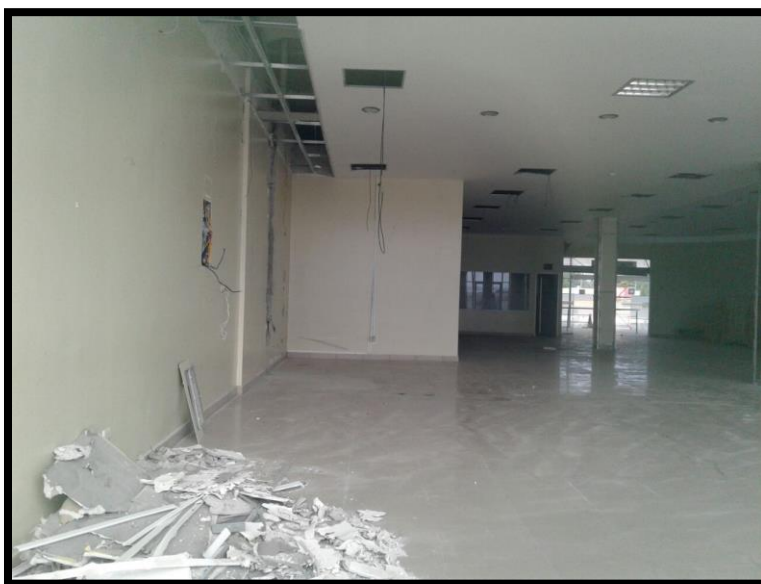
Sala de espera del Aeropuerto Internacional Eloy Alfaro de Manta, destruida.
