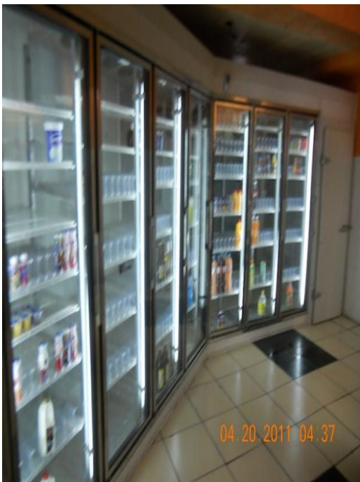
Cámara de frigoríficos
