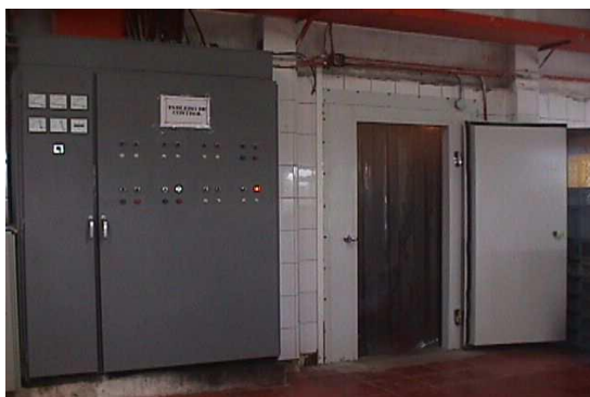
Cuarto de Frío
