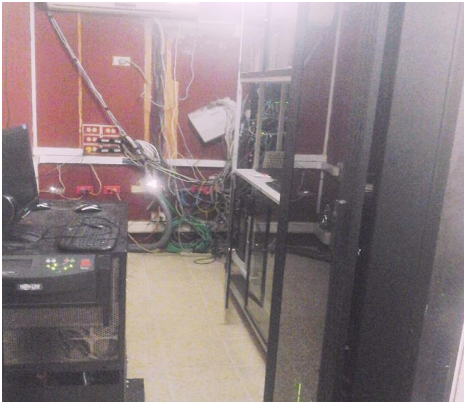
Anexo 3-D. Data Center de la Cooperativa Calceta Ltda.
