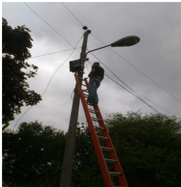
Foto. 4. Cambio de reflector
