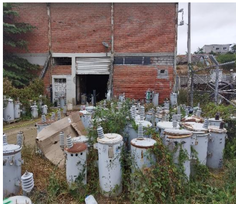
Fotografía 1.- Vista frontal patio taller de transformadores
