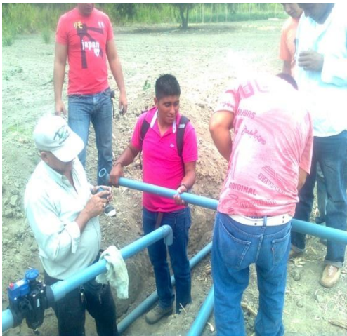
ARMADO EL CABEZAL DE RIEGO
