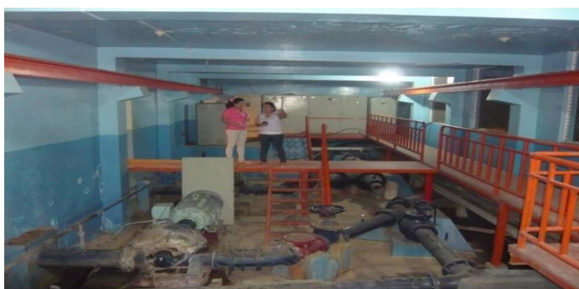
Anexo 7-A; medición de iluminación en la noche en estación de bombeo 3
