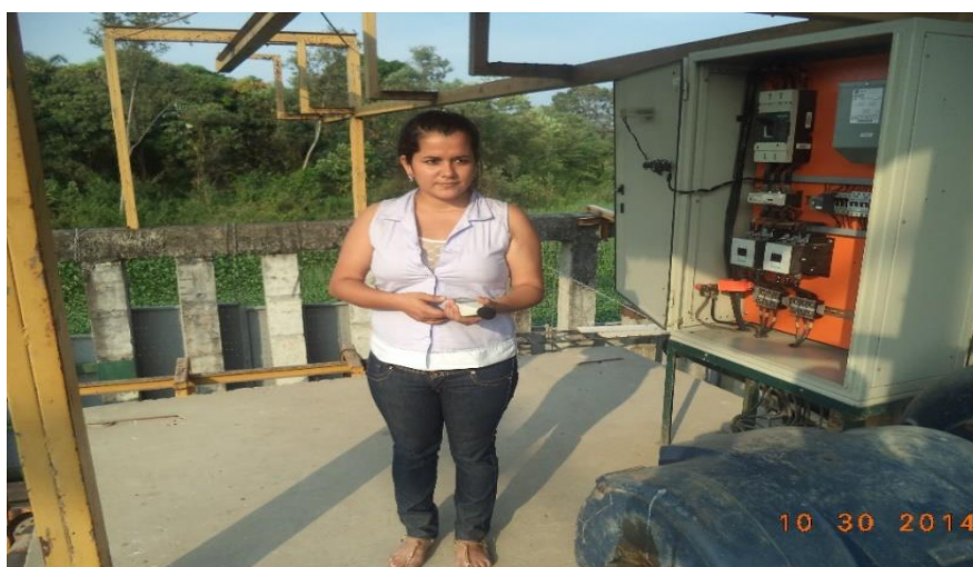
Anexo 5- A; medición de ruido en la estación de bombeo 1
