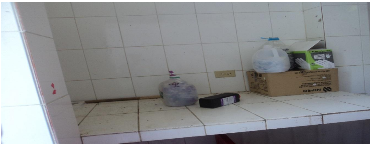
Fotos 6. 8. Falta de rotulación de desechos especiales en almacenamiento final
