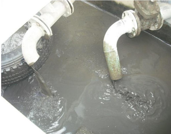
1-A Toma de muestra al vaciado del sedimentador
