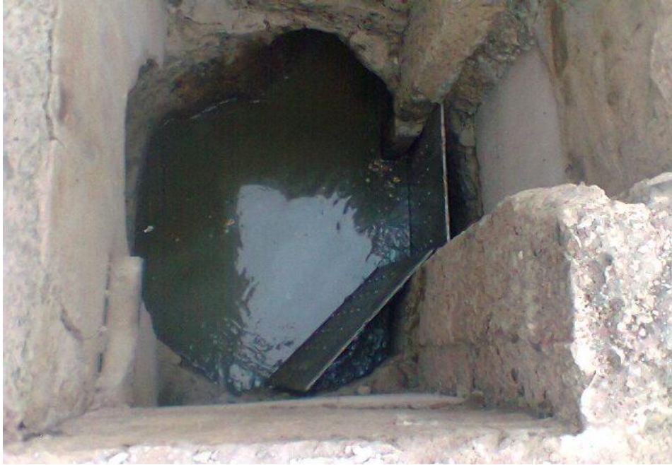
Caja de recepción del agua residual en la estación de bombeo
