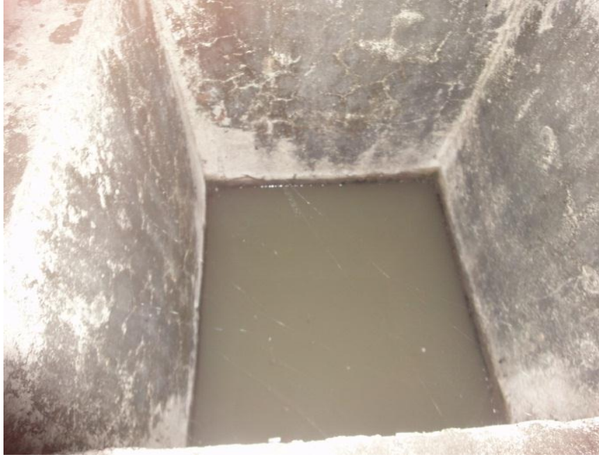
Cajón de Llegada
