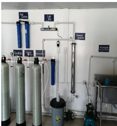
Foto 4.9. Proceso de la planta purificadora
