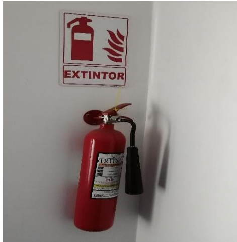
Foto 4.7. Extintor de la planta purificadora
