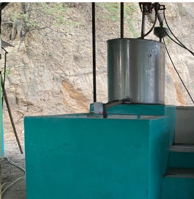
Foto 4.14. Sistema de condensación, torre de enfriamiento y destilación de alcohol.
