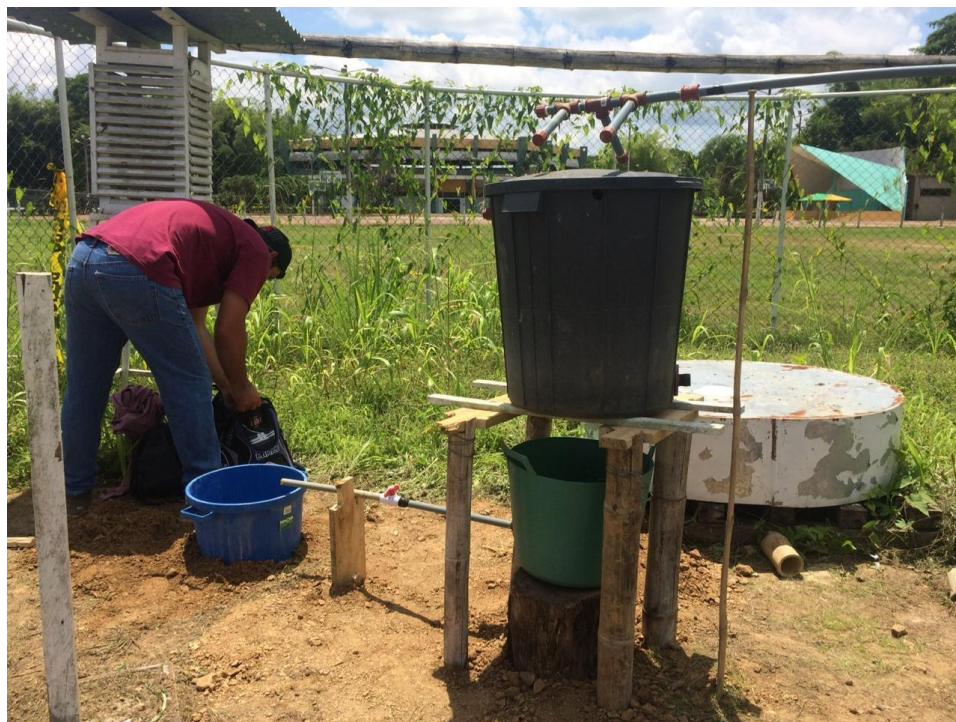
Anexo 7c. Filtro percolador del sistema de tratamiento.
