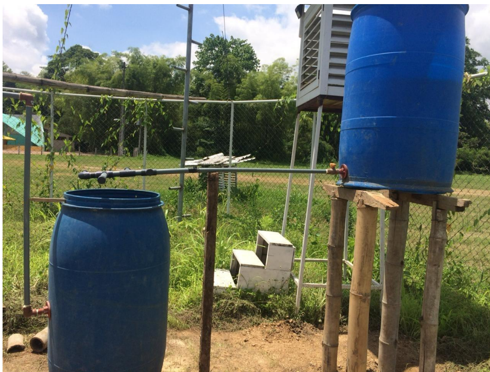
Anexo 7b. Reservorio para el almacenamiento del agua residual.
