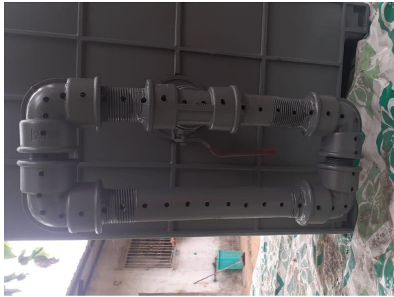
3-B. Tubería de PVC para riego del agua.
