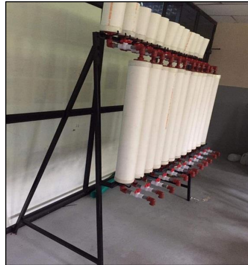
Anexo 2-K Sistema biofiltración
