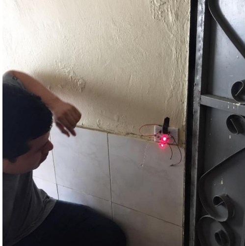
Figura 3. 20 Instalación de contador de personas
