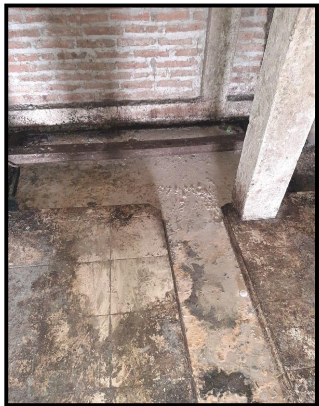
Imagen 3. Cisterna de residuo líquido.
